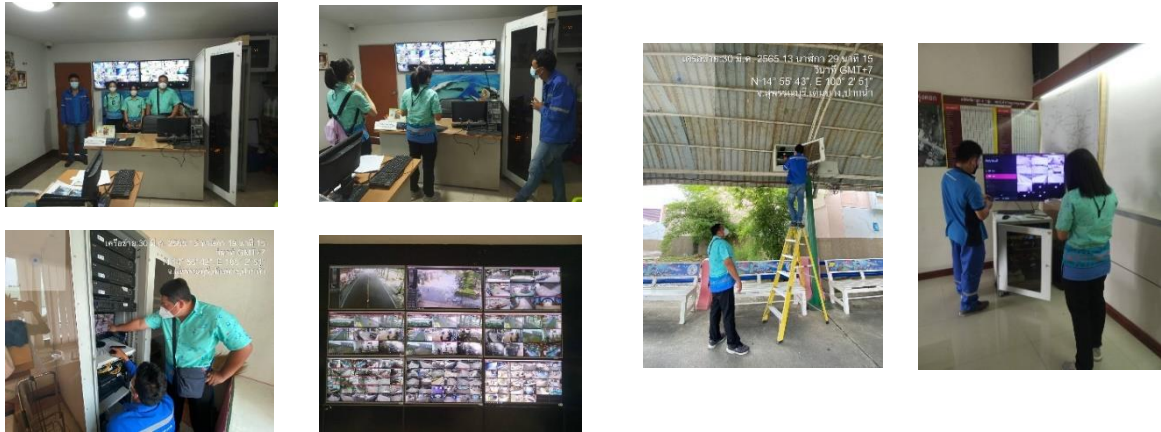
ดำเนินการตรวจติดตามงานโครงการซ่อมบำรุงรักษาระบบกล้องโทรทัศน์วงจรปิด(CCTV) ณ สภ.สระแก้ว อ.เมืองสุพรรณบุรี และ สนามกีฬาดอนเจดีย์ , สภ.ดอนเจดีย์ อ.ดอนเจดีย์ จ.สุพรรณบุรี
